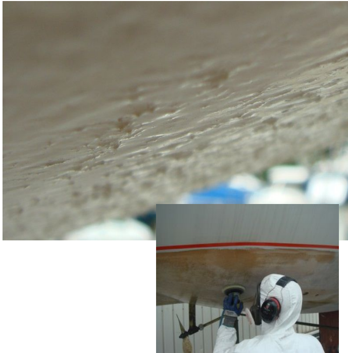
« Wick effects » on surface : Necessary to sand
